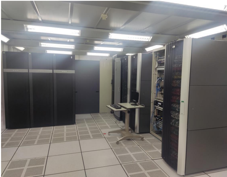
Figura 5.51: Sala cofre I
