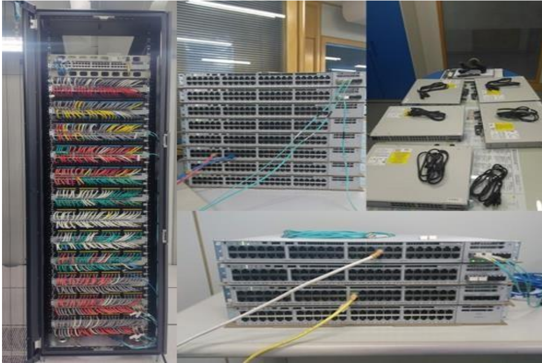
Figura 5.45: Rack Rede interna SEDE – Switchs Cisco C9200
